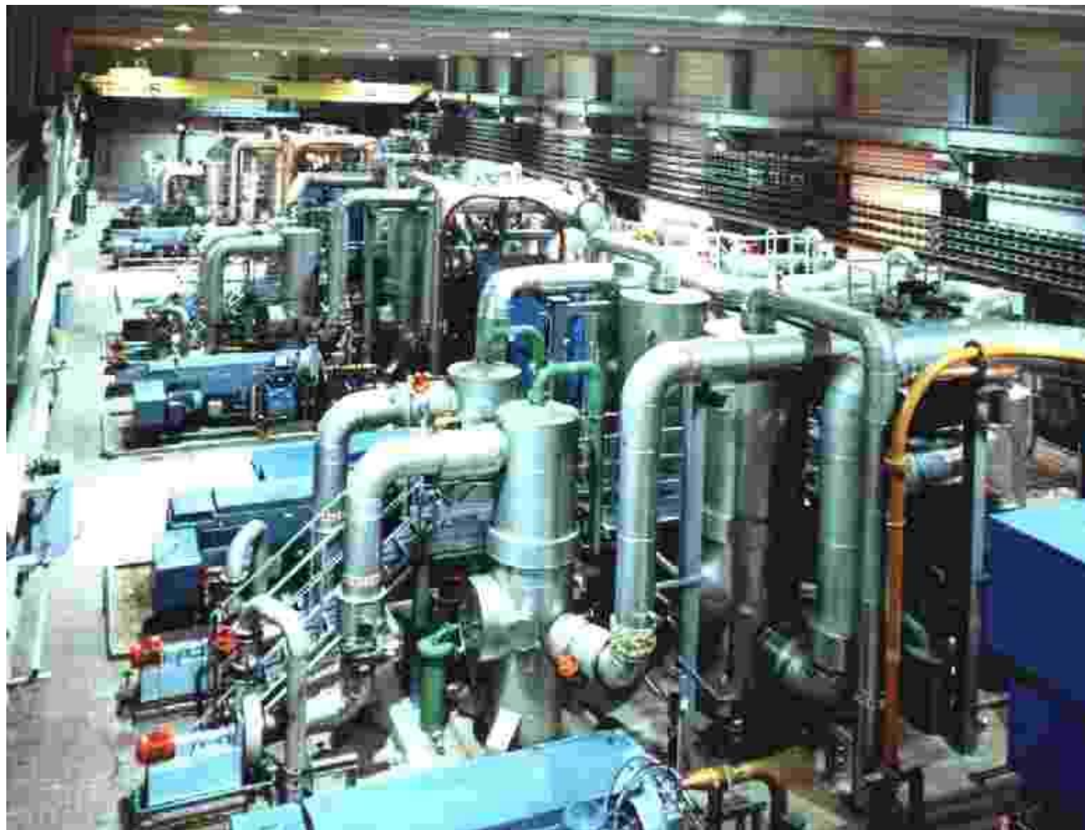
Dreistufige Brüdenkondensation: Heizwärme, Schlammvorwärmung und Restwärme auf einer Großkläranlage
