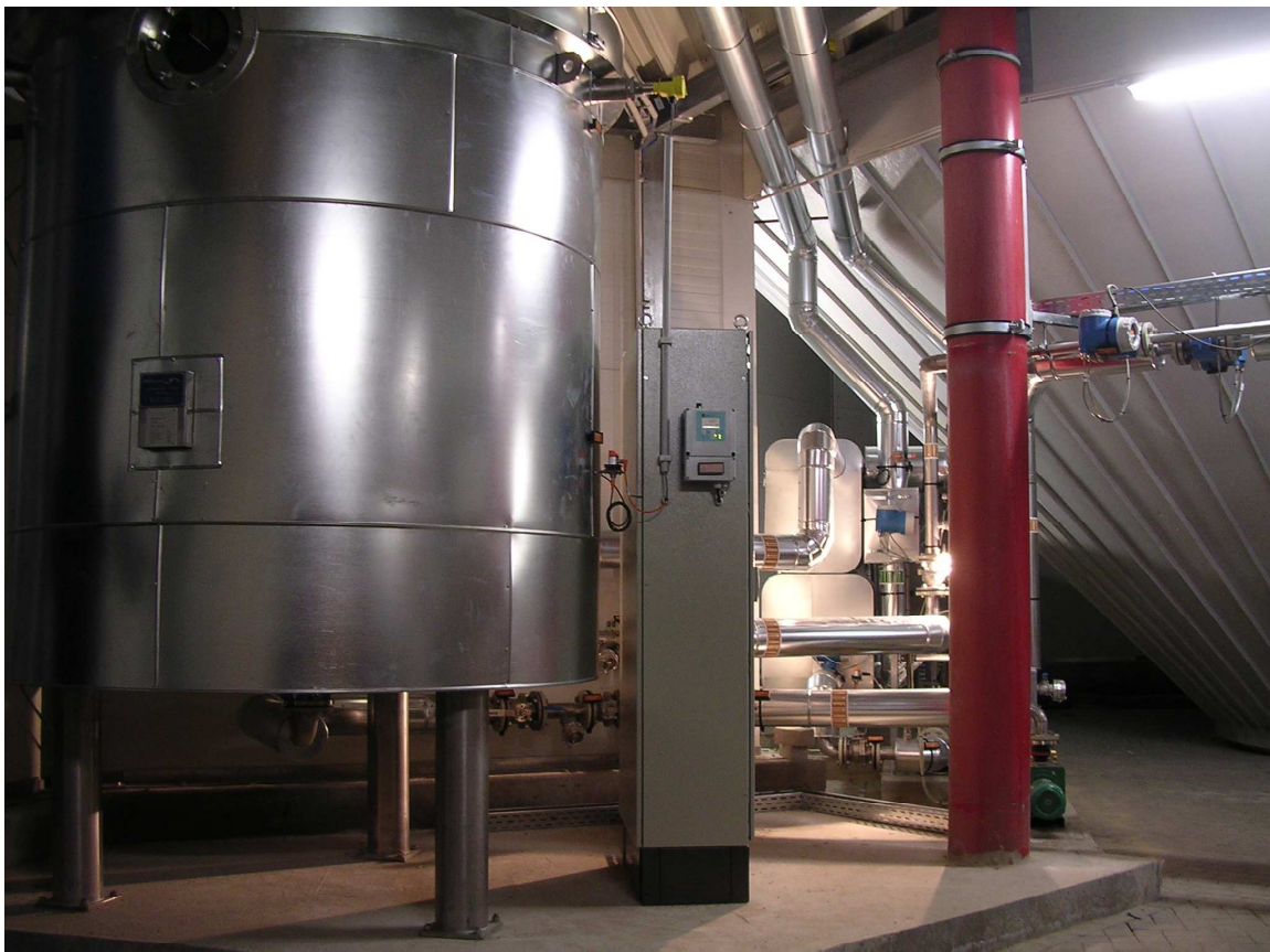
Anlage zum thermisch-chemischen Zellaufschluss in Gifhorn
