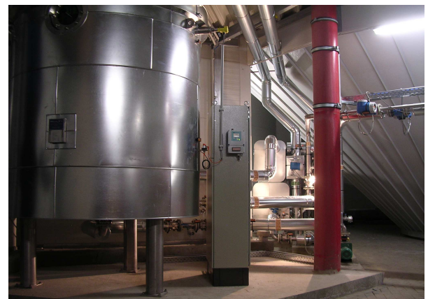
Bild 5: Reaktor mit Schaltschrank
