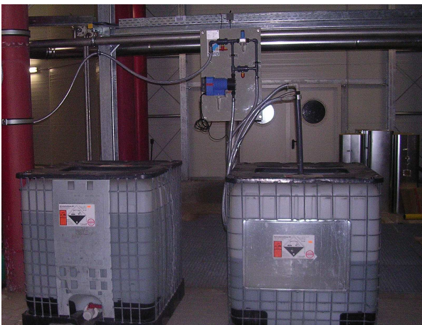
Bild 7: Dosierstation für die Natronlauge
