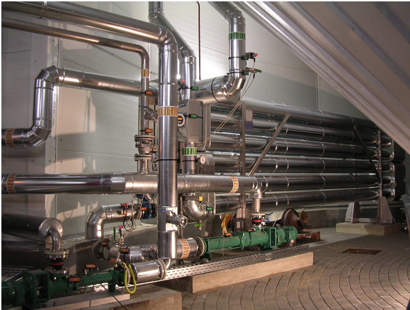
Bild 6: Wärmetauscher und periphere Pumpen
